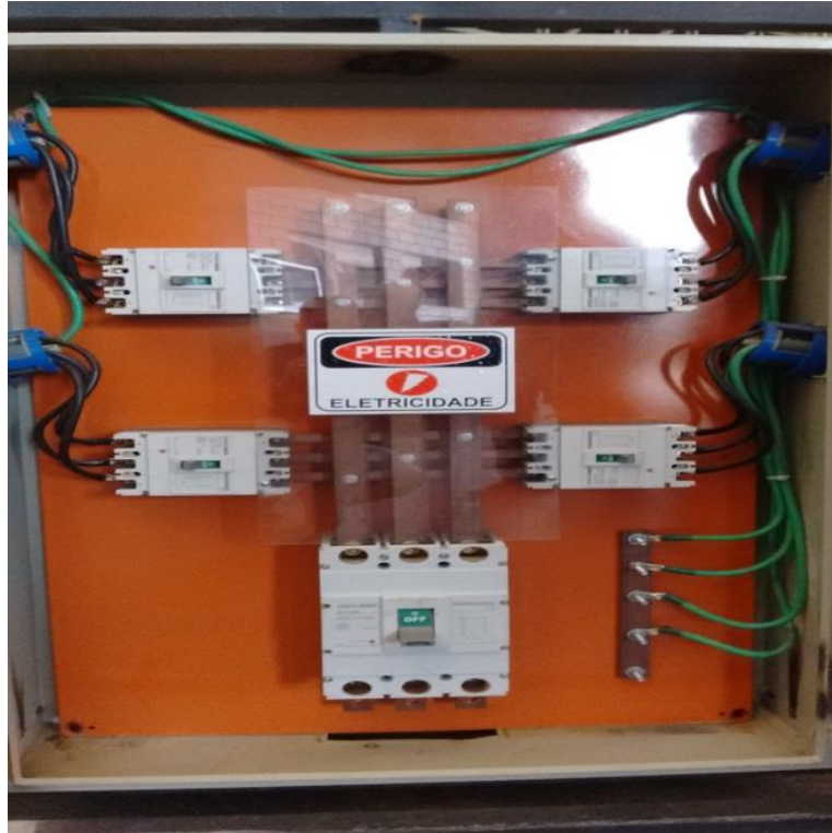
QUADRO DE DISTRIBUIÇÃO COM DISJUNTOR GERAL, BOBINA DE SUBTENÇÃO COM BARRAMENTO DISTRIBUIDO PARA 04 DISJUNTORES INDEPEDENTES COM BARRAMENTO PARA ATERRAMENTO
